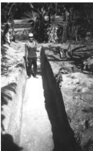
PHOTO/FOTO 3 The width of the trench varies according to the size of the tube La largeur de la tranchée varie selon les dimensions du tube El ancho de la zanja varía de acuerdo con las dimensiones de la tubería Photo/Foto: Lylian Rodríguez
