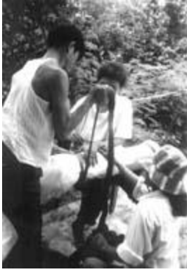
PHOTO/FOTO 4 Fitting the inlet pipe Installation du conduit d'admission Ajuste de la tubería de entrada Photo/Foto: Veronika Brezki
